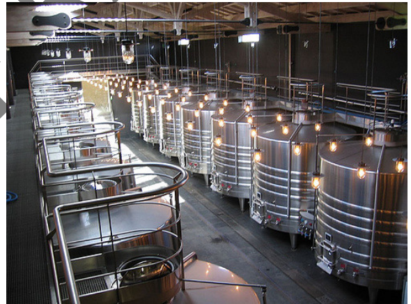
Airtight, fermentation tanks
